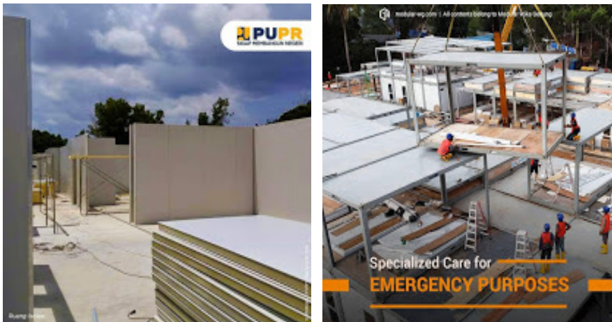
Gambar 13. Pembangunan Fasilitas Observasi/Karantina Pengendalian COVID-19 di Pulau Galang, Batam, Indonesia (Sumber: kemenPUPR IG & Modular Wika Gedung IG )
